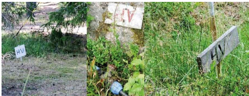
Väl uppmärkta ventiler
